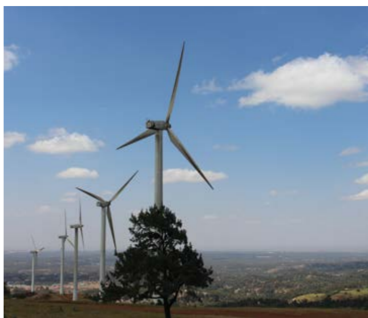
Parc éolien de Ngong Hills, Kenya
